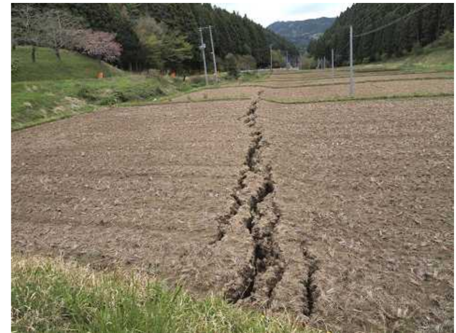
写真4：写真1の地点の北側の状況。雁行状の亀裂が直線上に連続する。水平方向の変位が主体で、鉛直方向の変位は小さい。写真奥側は、撓曲状に変形している。
